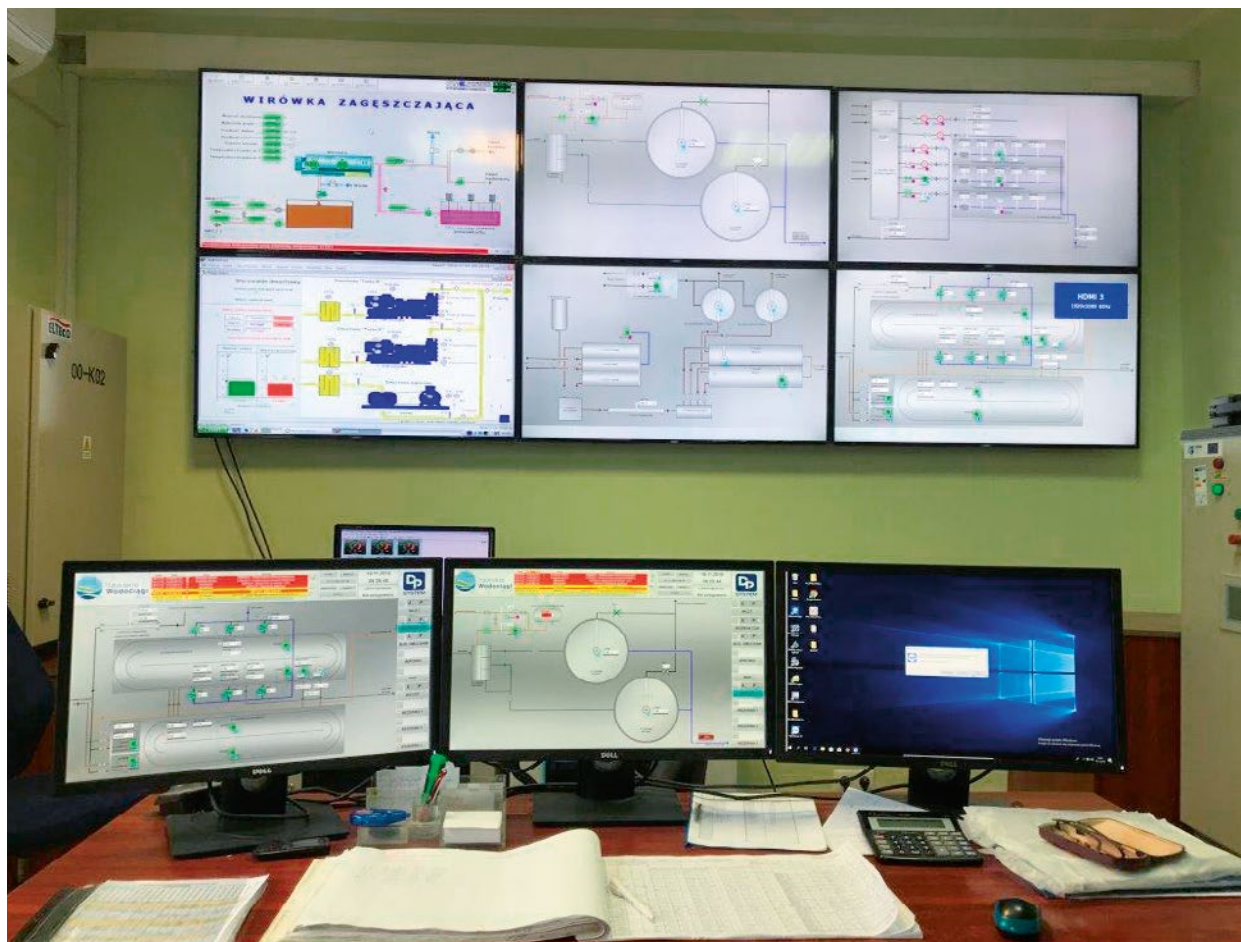
Monitoring on-line fot. archiwum spółki Iławskie Wodociągi
